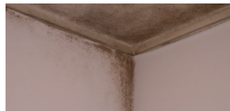
壁・天井の結露によるカビ発生例
